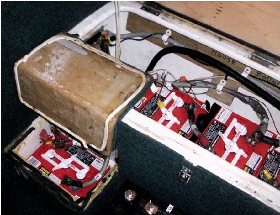
Une banque de six batteries au plomb Endurant CR232, mortes après deux ans de service à bord d'un catamaran 44.
